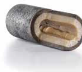
труба охлаждения с отложениями
